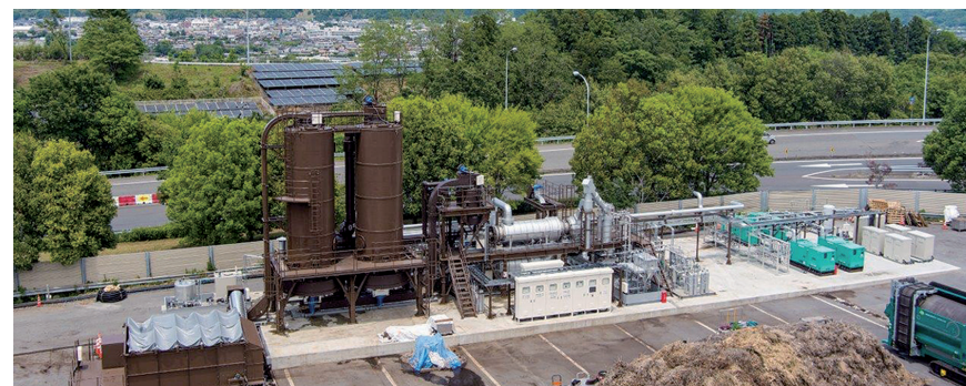
富岡バイオマスガス化発電プラント(上信越道 富岡IC敷地内)
