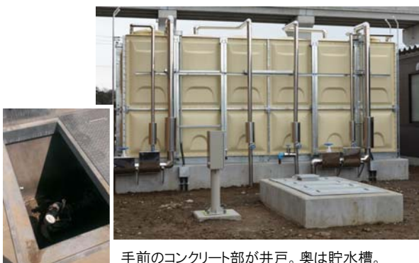
手前のコンクリート部が井戸。奥は貯水槽。
