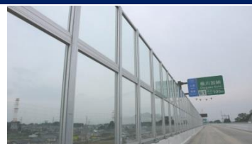
▲透光性遮音壁。遮音性に加え、ドライバーにとっても圧迫感のないよう眺めが確保され、近隣住民の方にも日照が確保されるよう配慮した部材を採用している。
