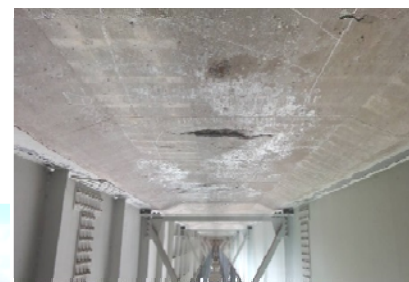
(上) 床版上面の損傷（舗装撤去後） (下) 床版下面の損傷
