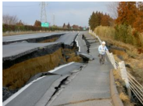
▲盛土の崩落（常磐道 水戸IC～那珂IC間） 平成23年3月11日撮影
