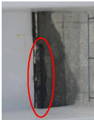
コンクリート剥離箇所
