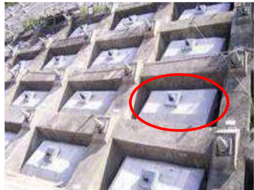
グラウンドアンカー
