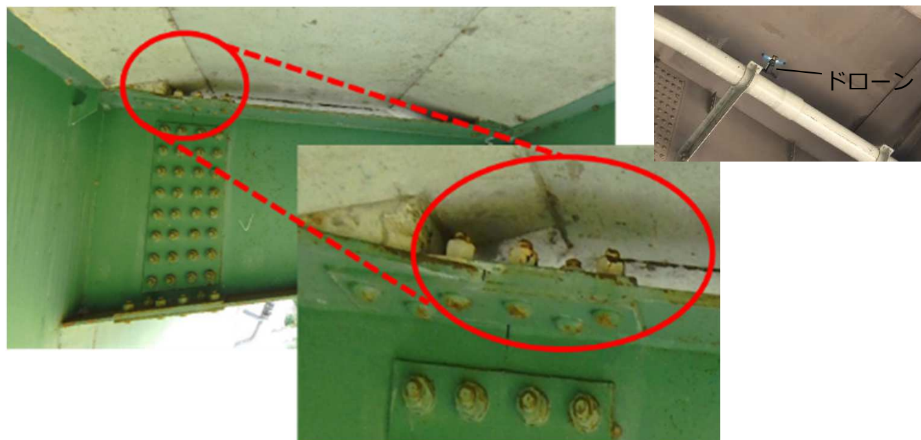
近接しづらい箇所での損傷確認（ドローンによる画像）
