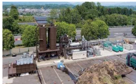
富岡バイオマスガス化発電プラント (上信越道 富岡IC敷地内)
