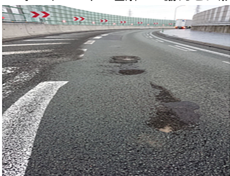
補修損傷状況
