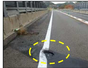
埋設型伸縮装置の損傷
