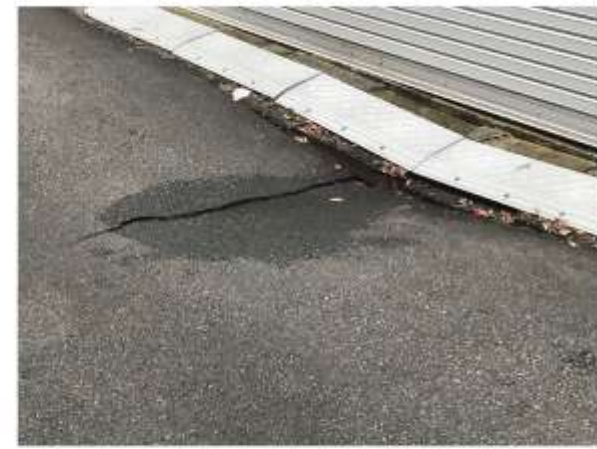
写真3 陥没箇所 (2020年10月18日_11:50舗装亀裂)
