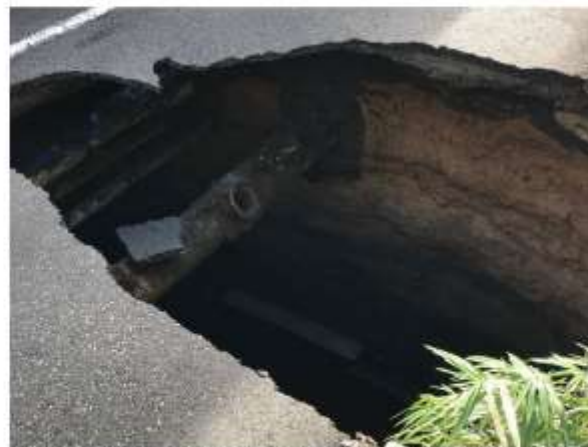
写真5 陥没箇所 (2020年10月18日_13:00_東側から撮影)
