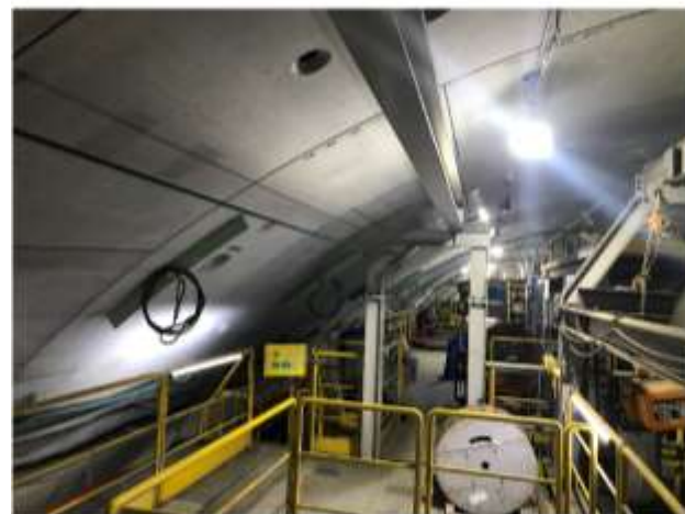
写真4 坑内状況写真(陥没位置付近左側)
