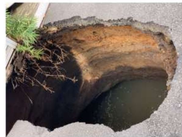
写真6 陥没箇所 (2020年10月18日_13:00_西側から撮影)
