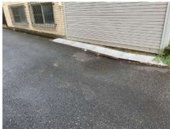
写真2 陥没箇所 (2020年10月18日_9:30水たまり)
