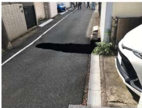
写真4 陥没箇所 (2020年10月18日_12:30)
