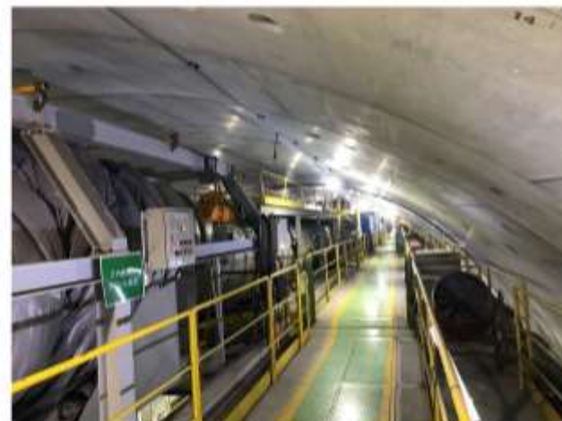
写真3 坑内状況写真(陥没位置付近右側)
