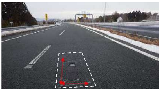
(路面損傷状況:ポットホール)
