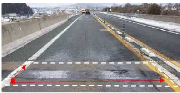
(路面損傷状況:伸縮装置破損)
