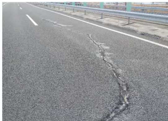
舗装のひび割れ
