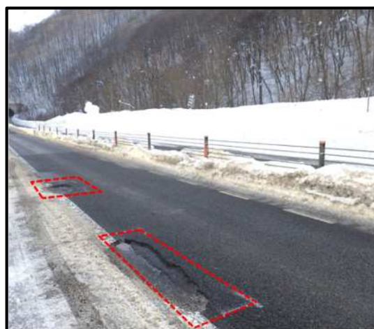
上り線 18. 65KP付近 損傷状況
