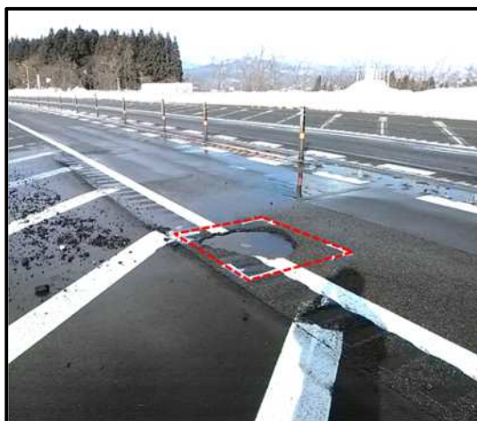
下り線 8. 70KP付近 損傷状況
