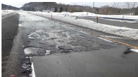
【路面損傷状況(ポットホール)】
