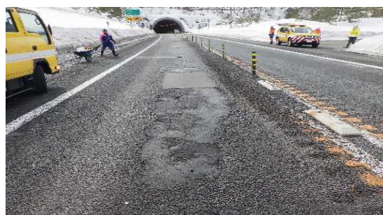
【路面損傷状況(ポットホール)】
