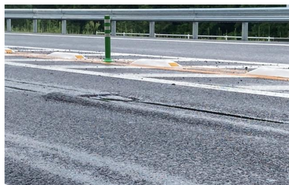
【損傷全景(応急復旧状況)】
