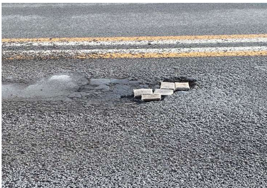
路面損傷状況
