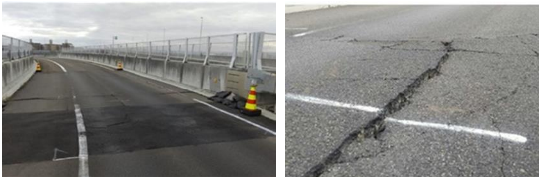
路面損傷状況
