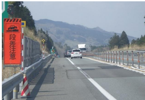
現在の路面状況
