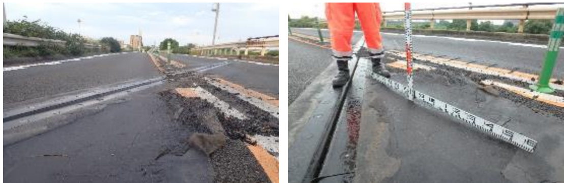
路面損傷状況
