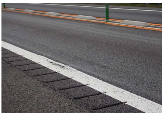
舗装の損傷(遠景)
