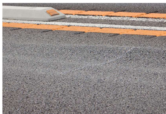
舗装の損傷(近景)
