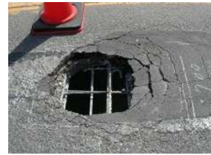
【道路が損傷した例】
