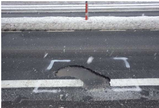
舗装損傷状況
