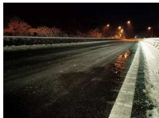
路面凍結状況
