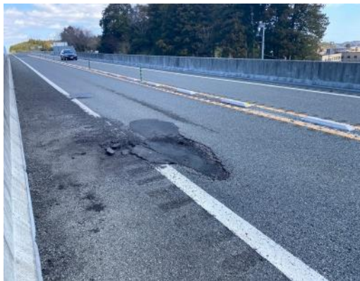
舗装損傷写真
