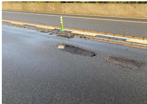
舗装損傷写真
