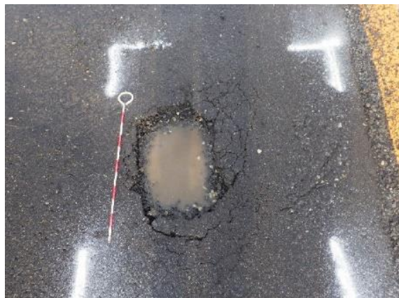
舗装損傷写真
