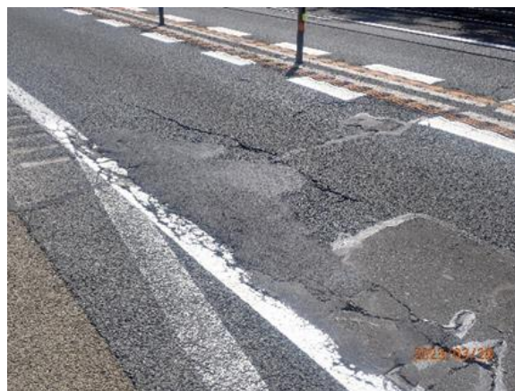
舗装損傷写真②
