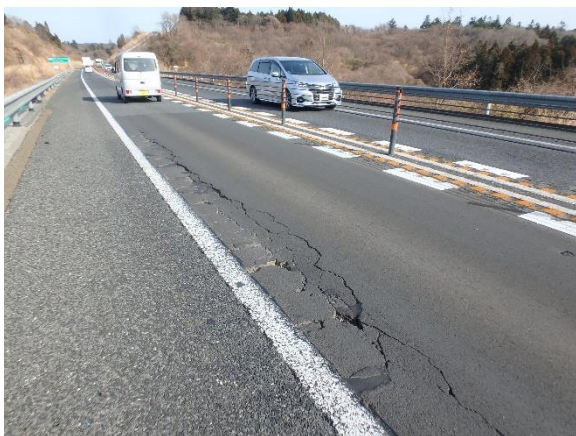
舗装損傷写真①
