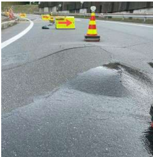
逗子IC 出口 路面隆起状況
