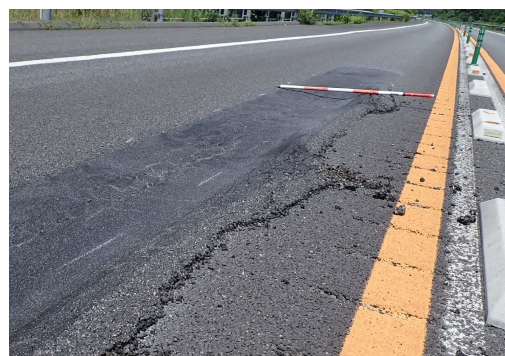
舗装の損傷(近景)
