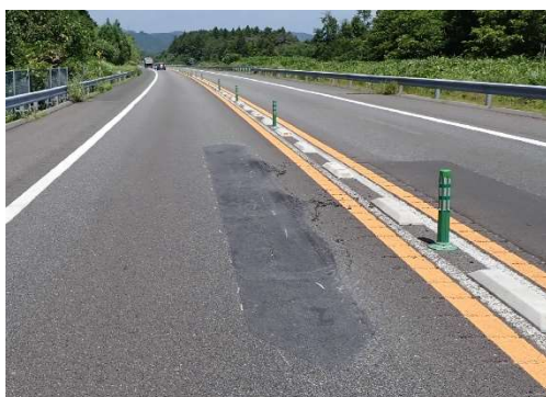
舗装の損傷(遠景)
