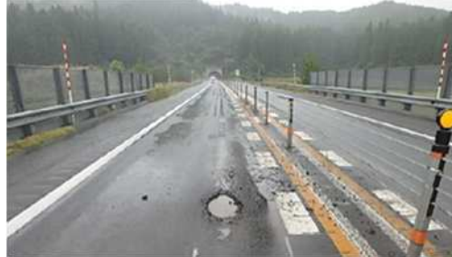
舗装損傷状況
