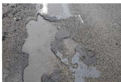
路面損傷の拡大状況(ポットホール)
