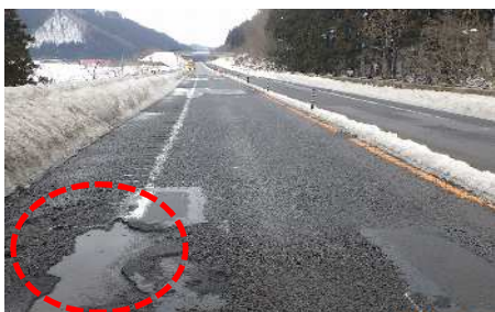
路面損傷状況(ポットホール)
