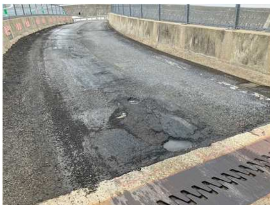
湯殿山 IC ランプの路面状況
