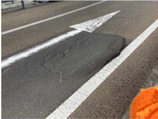
舗装損傷写真①
