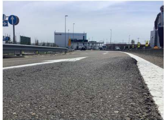
舗装損傷写真②
