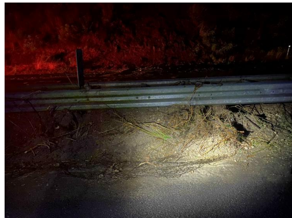
中央分離帯への土砂の堆積状況
