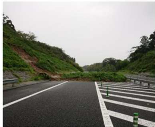
のり面の崩落
