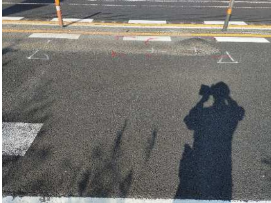
舗装損傷写真①
