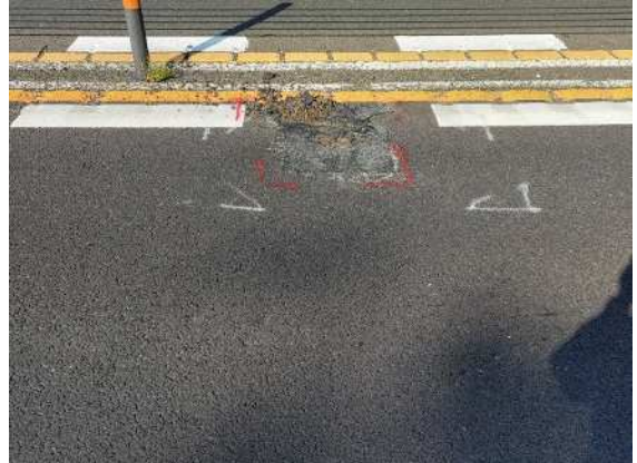
舗装損傷写真②
