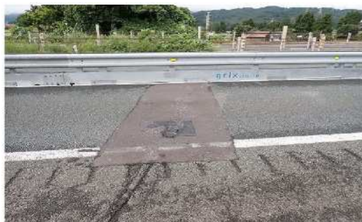
舗装の損傷(遠景)
