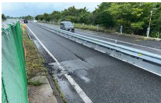
舗装の損傷(遠景)
