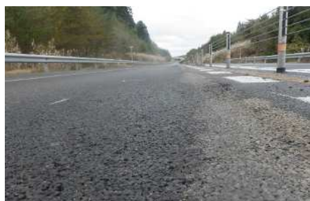
路面損傷の拡大状況(流動わだち)
