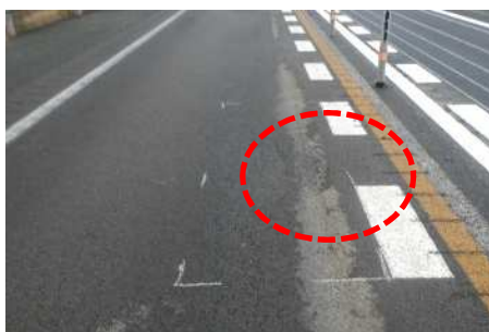
路面損傷状況(流動わだち)
