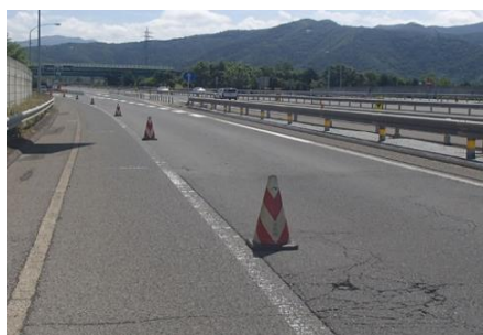
路面損傷状況
