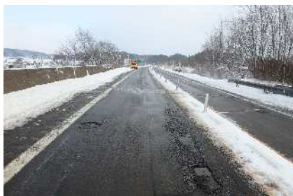
路面損傷状況
