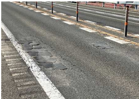
舗装損傷状況①
