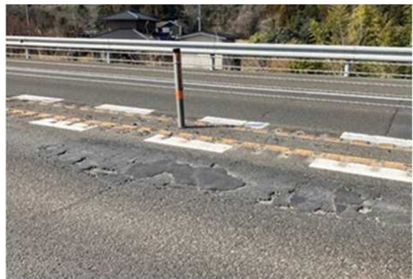
舗装損傷状況②
