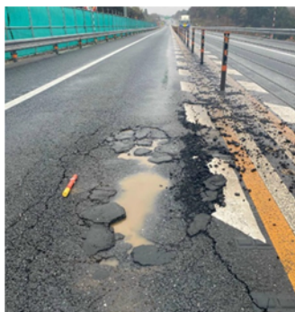
路面損傷状況
