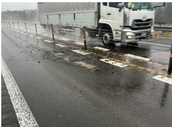
舗装損傷写真
