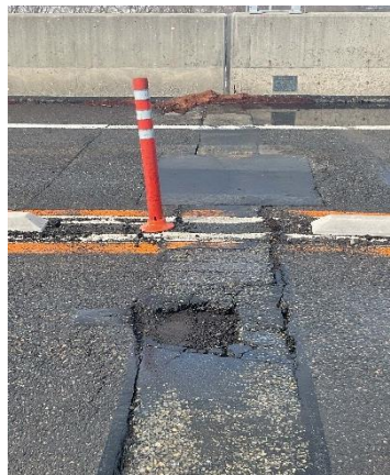
路面損傷状況
