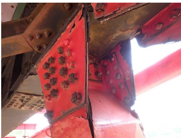
②箇所:損傷状況
