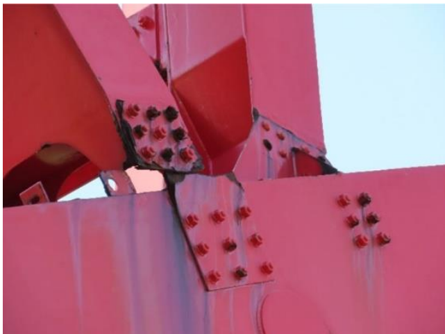
①箇所:損傷状況
