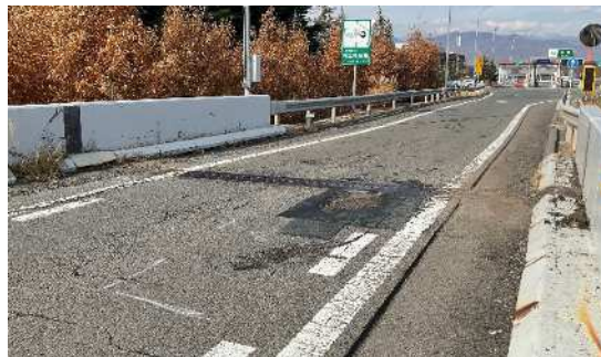
<舗装損傷状況>
