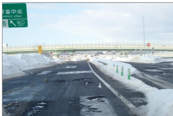
道路の損傷状況
