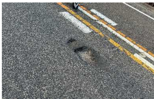
舗装損傷状況
