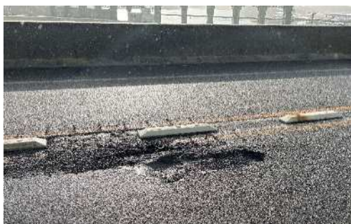
舗装損傷状況
